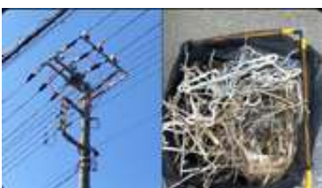
TEPCO(東京電力)「カラスの巣を見つけたら連絡を」(東京電力資料より)。電力会社では、電柱に作られたカラスの巣が原因で起こる停電(営巣停電)が長年の課題だ。従来は作業員が巡回していたが、現在は市民からの報告が大きくなってきている
